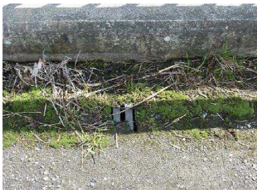
【排水ますの土砂詰まり】
