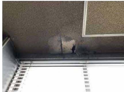
天井仕上材の剥がれ
