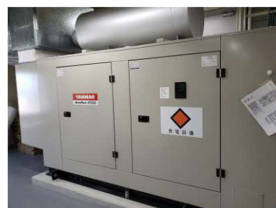
非常用自家発電設備
