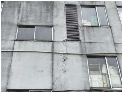
外壁コンクリートの剥がれ
