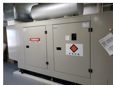
非常用自家発電設備
