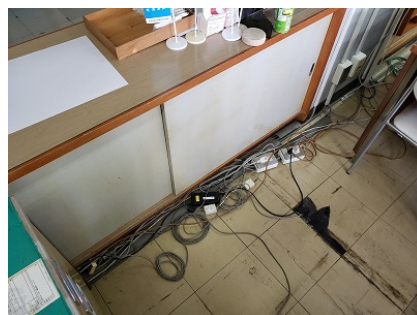
露出した配線
