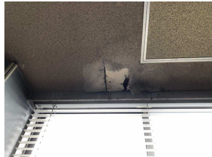
天井仕上材の剥がれ
