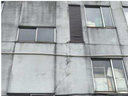
外壁コンクリートの剥がれ
