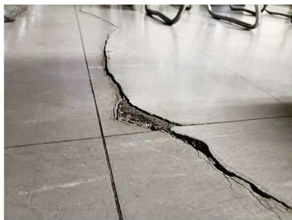
床コンクリートのひび割れ
