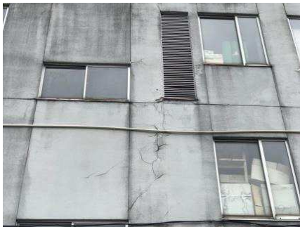
外壁コンクリートの剥がれ
