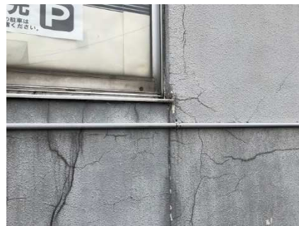
建具回りの防水劣化
