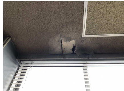
天井仕上材の剥がれ
